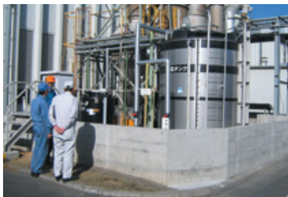
外部漏洩防止対策の実施を確認(葦崎事業所)
